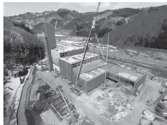
平成30年12月から稼働予定のエネルギー回収施設（川口）
