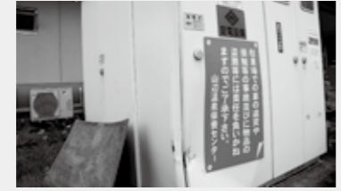
車の衝突によると思われる損傷
