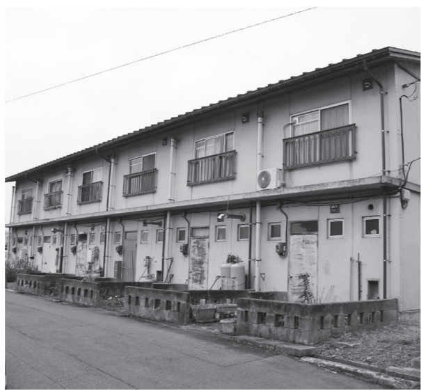
耐用年数により老朽化が懸念される芦沢町営アパート
