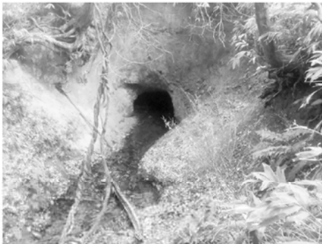
いまだに入口が崩壊りトンネルの愛宕山すい道
